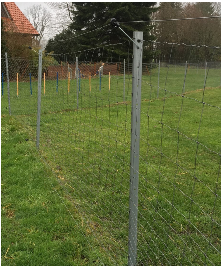
Untergrabungs- und Überkletterungsschutz durch stromführenden Draht
